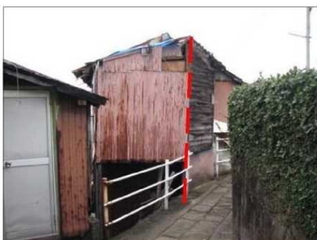
一部の柱が傾斜している例
