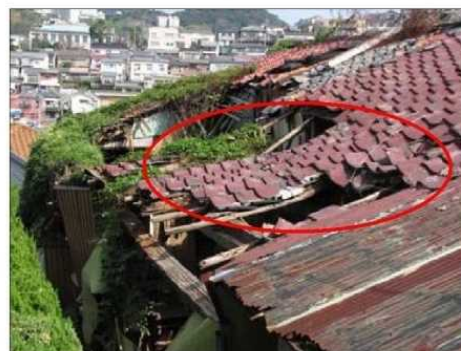
柱、はりの破損や変形が著しく崩壊の危険がある例
