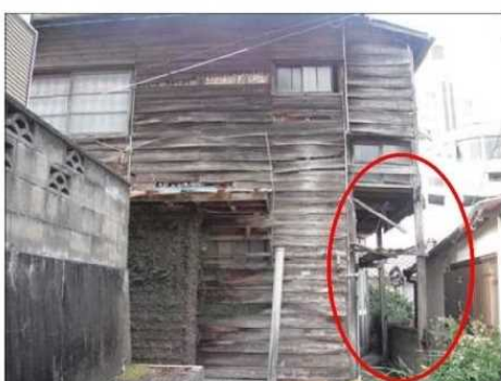
柱の数箇所に破損がある例
