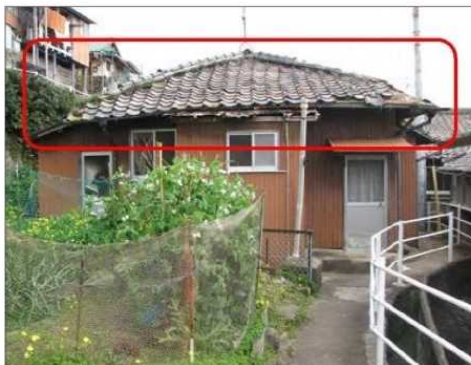
屋根に不陸がある例
