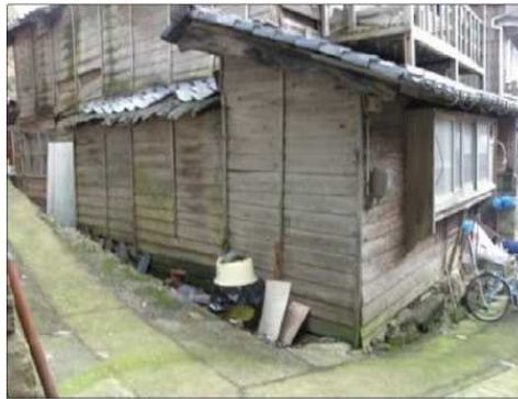
外壁が裸木造の例
